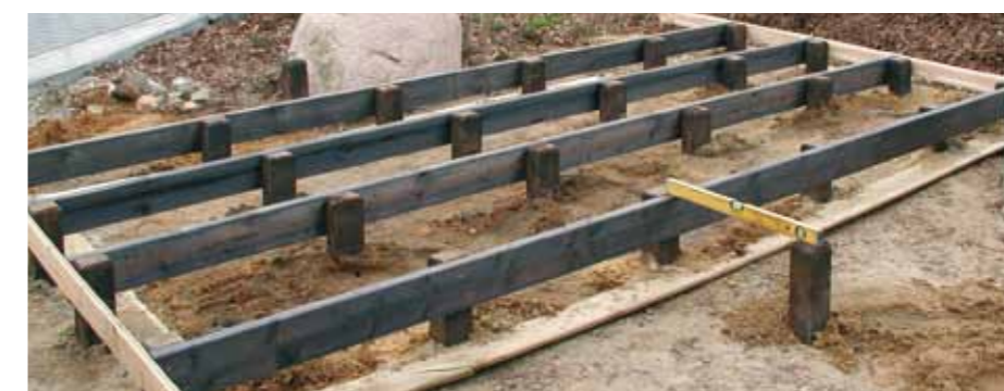
Eine weitere Möglichkeit, einen Terrassenunterbau zu erstellen besteht darin, imprägnierte Vierkantpfosten in dichtem Abstand in die Erde zu setzen (siehe Foto). An die Pfosten werden dann 4 x 14 cm Bohlen (kesseldruckimprägniert) quer angeschraubt (genau ausrichten). Diese sind dann die Auflagehölzer für die Terrassendielen.
